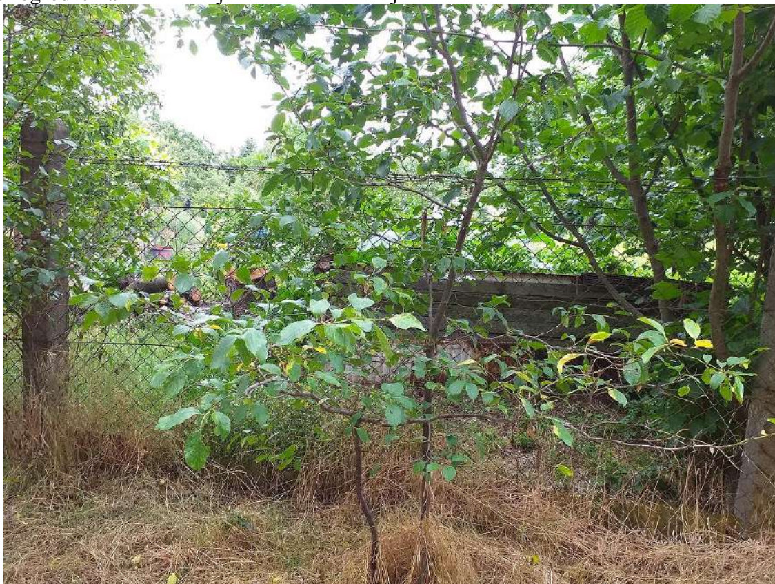
Stan ogrodzenia ROD Kolejarz od ul. Źródlanej – do rozbiórki.
